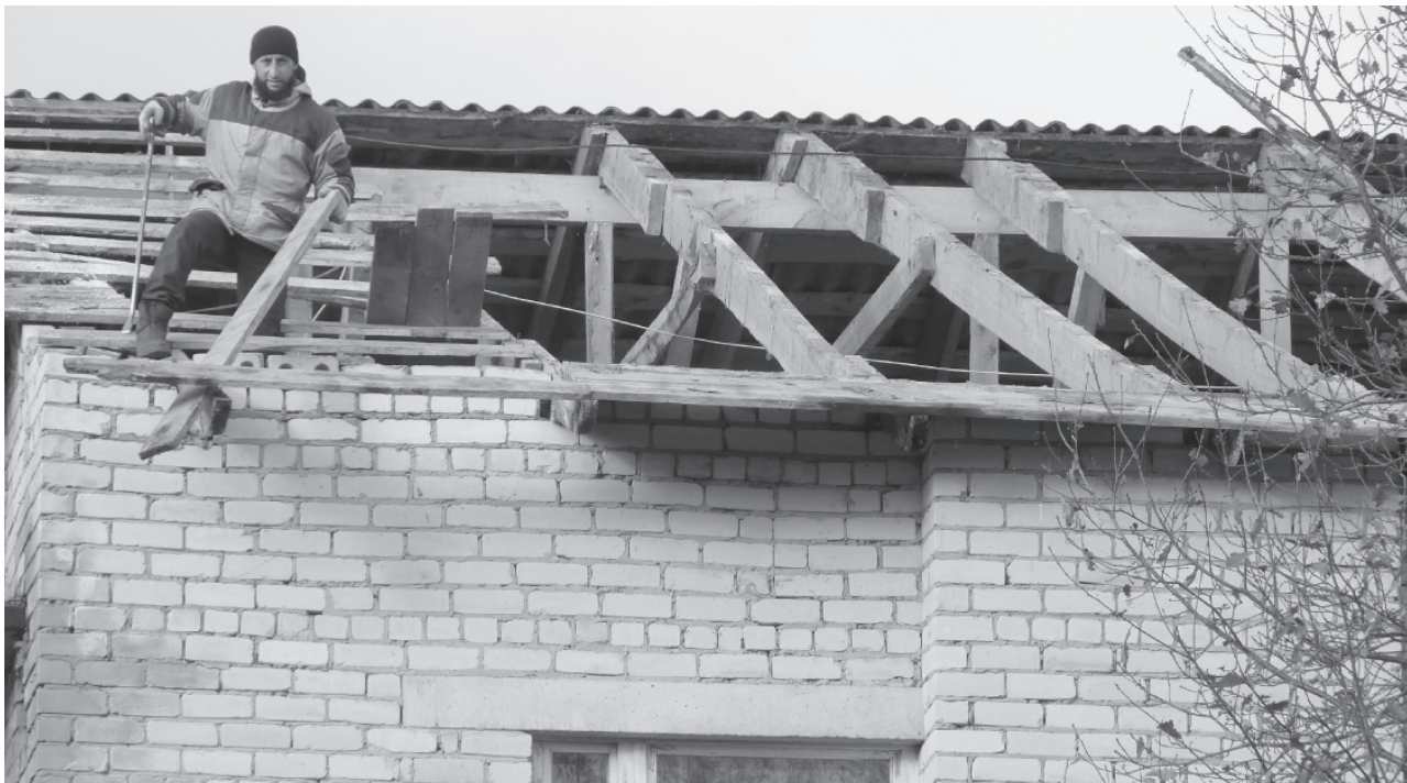
На фото: п. Пречистое, ул. Ярославская, 96. Крышу дома ремонтируют уже 3-й месяц
