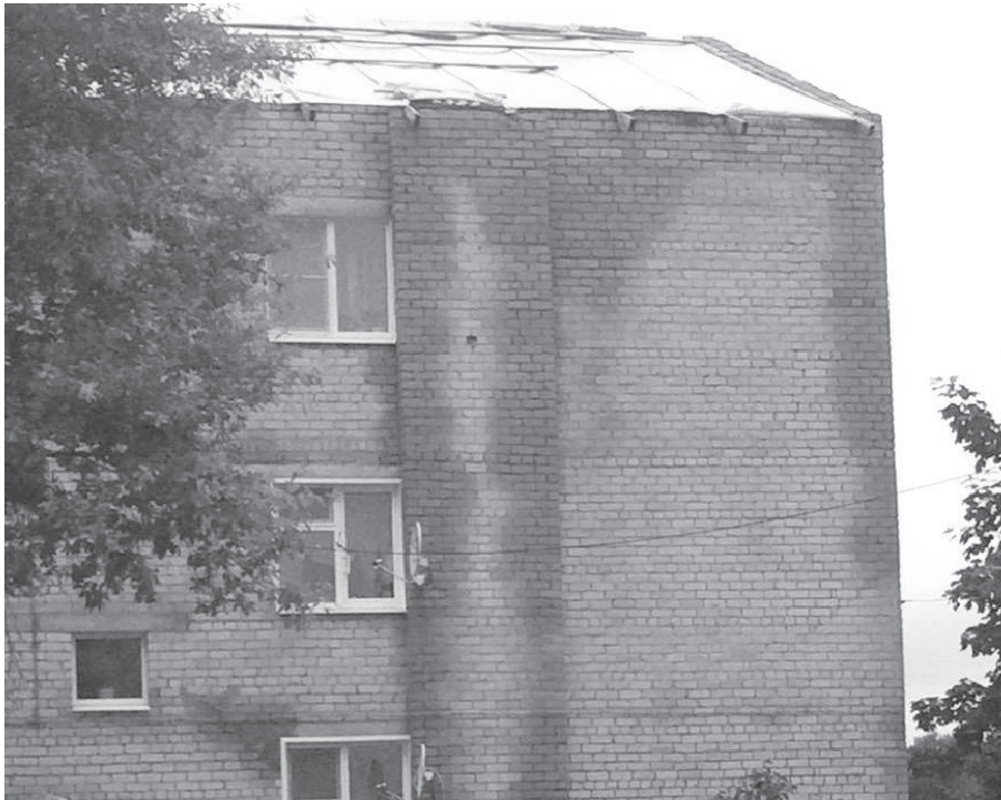
На фото: «голая» крыша и мокрые стены - результат капремонта дома №96 на улице Ярославской в Пречистом
